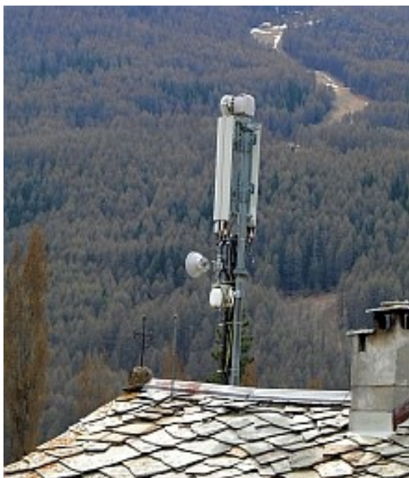
Foto degli impianti
