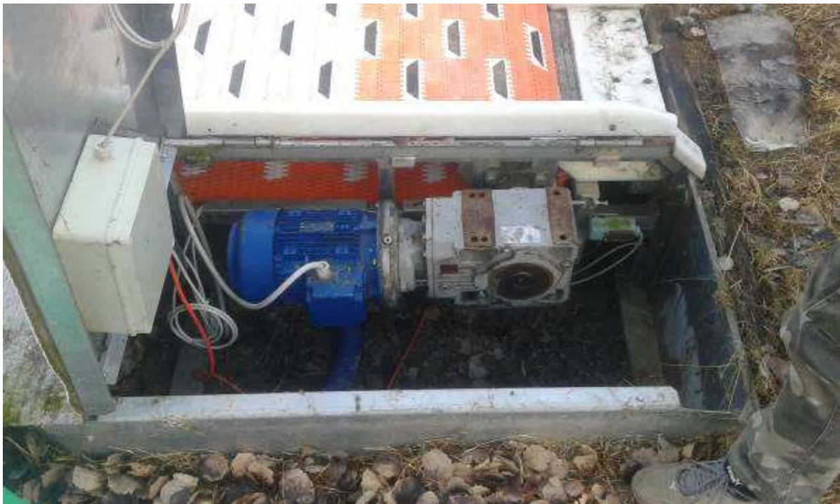
Stazione di Monte vano motore
