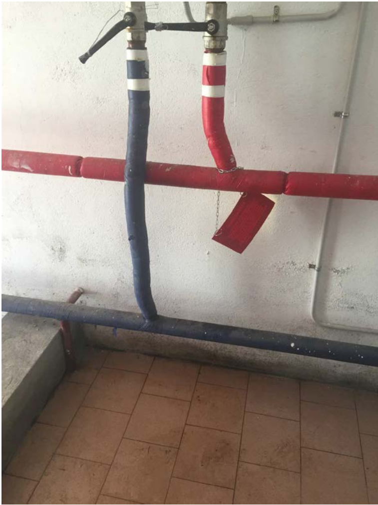
Condotte esistenti sulla parete Ovest da rimuovere
