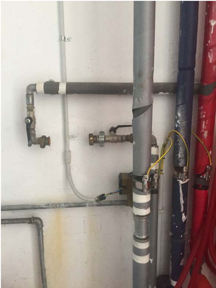
Condotta di ingresso acqua all'impianto
