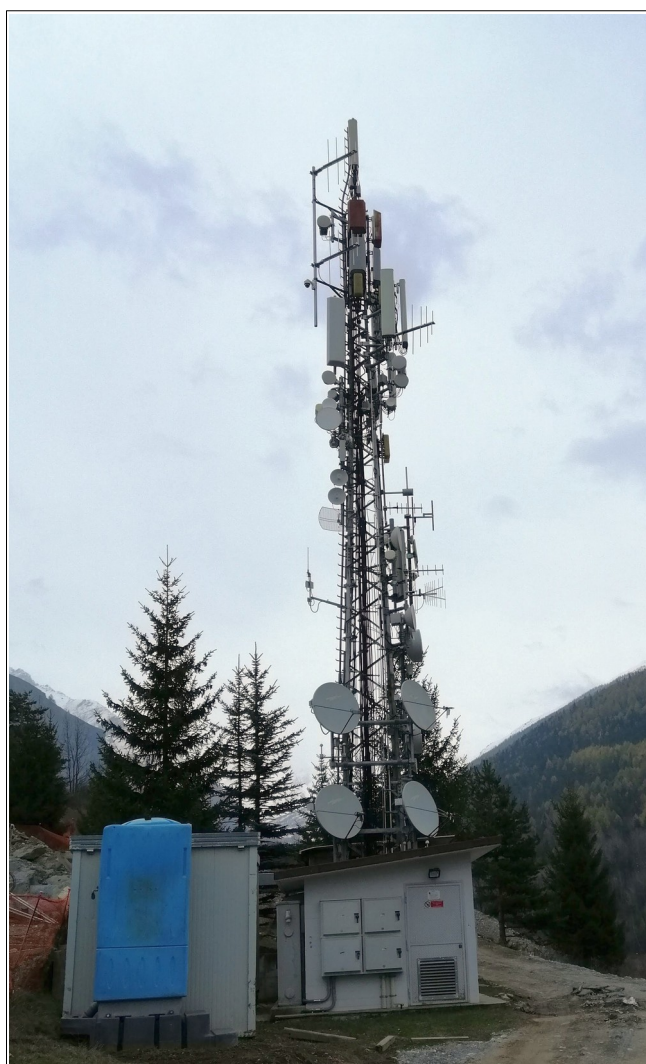
Foto 1 – Impianti di località Bacinetto
